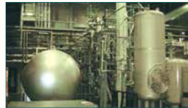
▲ 閉鎖実験施設の物理化学処理装置
