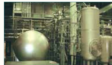
▲ 閉鎖実験施設の物理化学処理装置
